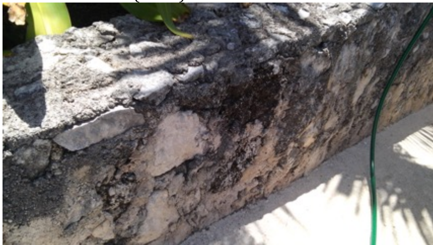
Paredes con moho (Antes):
