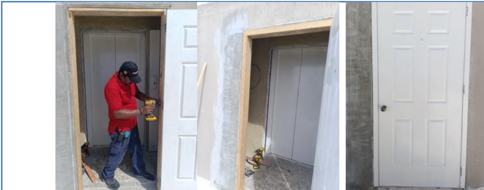
Se reparó el Estuco de donde se encontraba la Antigua Entrada del Elevador:
