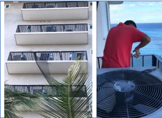
Se Limpiaron las Ventilaciones de las Secadoras:
