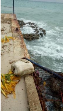
Fencing Broke: Reja se rompió
