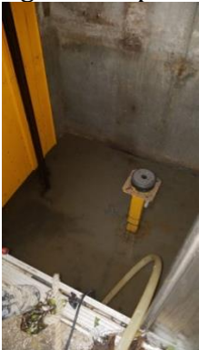
Elevator Bays Flooded: Agua en la parte de abajo de los elevadores:
